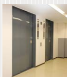
貨物用エレベーター（Fバンク）
