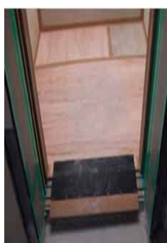
エレベーター出入口 1
