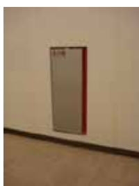
共用部(消火器) 1
