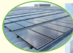
屋上に設置された太陽光パネル
