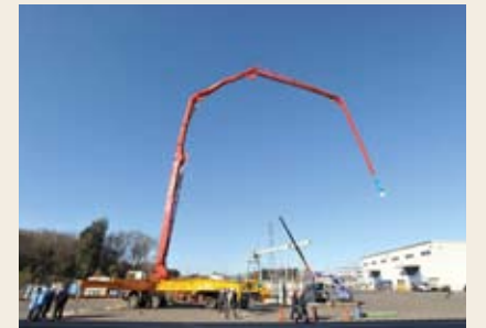
東京電力に無償提供されたポンプ車
